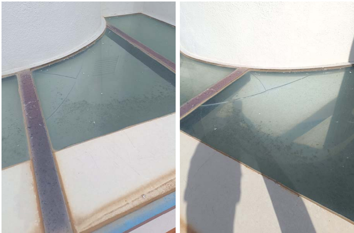
Fisuras y roturas en claraboyas de terrazas transitables.
